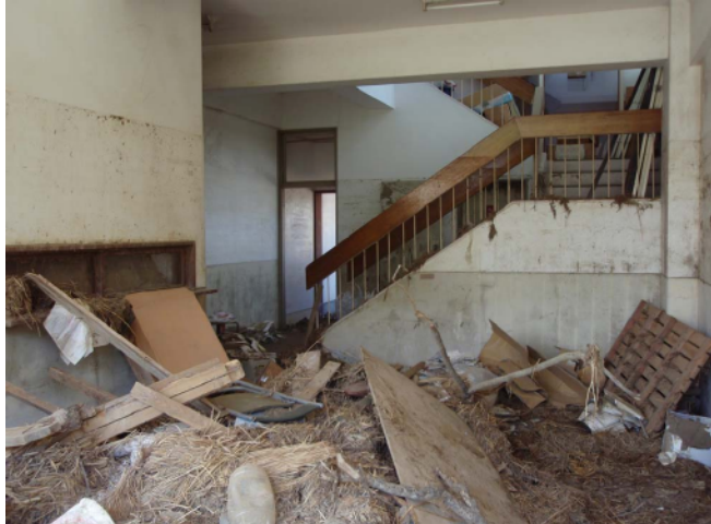
1階の一部は津波の影響で壊滅状態になっている。
