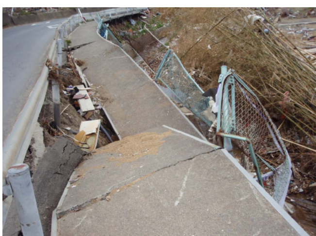
倒壊した道路。
